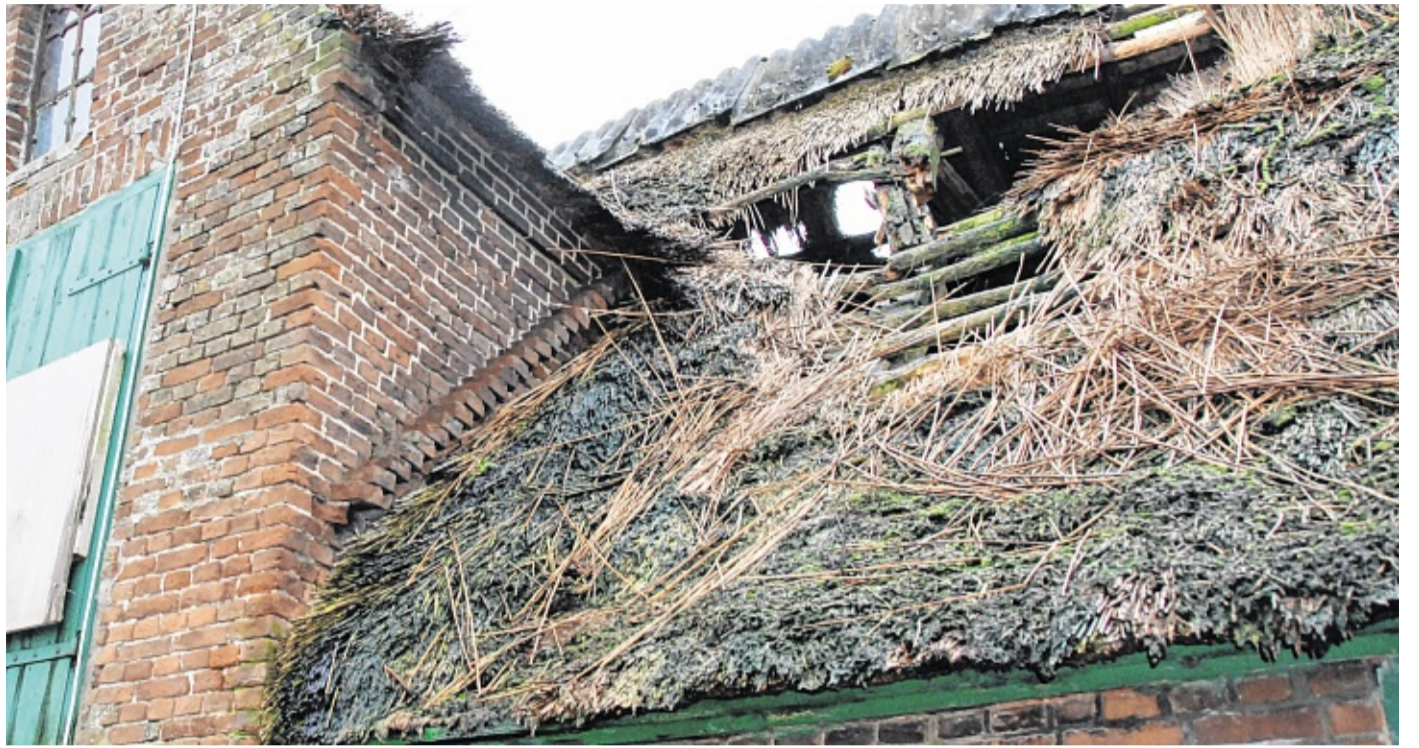
Bei dieser Scheune war nichts mehr zu retten. Die betagte Bausubstanz musste dem Erdboden gleichgemacht werden. In vielen Fällen kann man durch eine günstigere Bedachung aber wenigstens historische Gemäuer für künftige Generationen erhalten. MEHMEL
